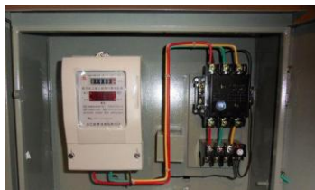
图1 灌溉智能电表配电箱
