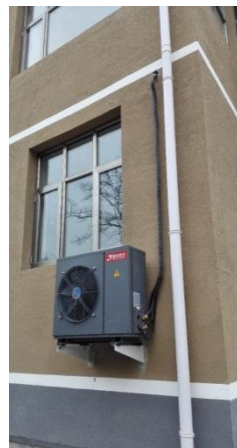
图5 空气源热泵室外机
