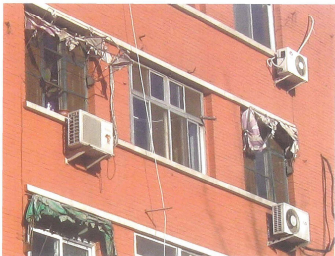
改造前空调放置现场照片
