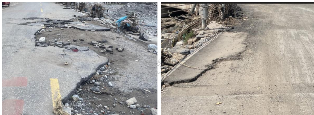
图 4.1.2-6 沥青混凝土面层剥落
