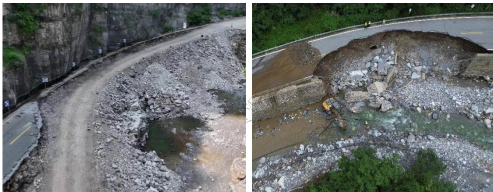
图 4.1.2-1 沿河公路路基冲毁
