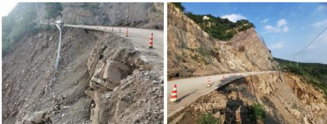
图 4.1.2-2 路基边坡失稳损毁
