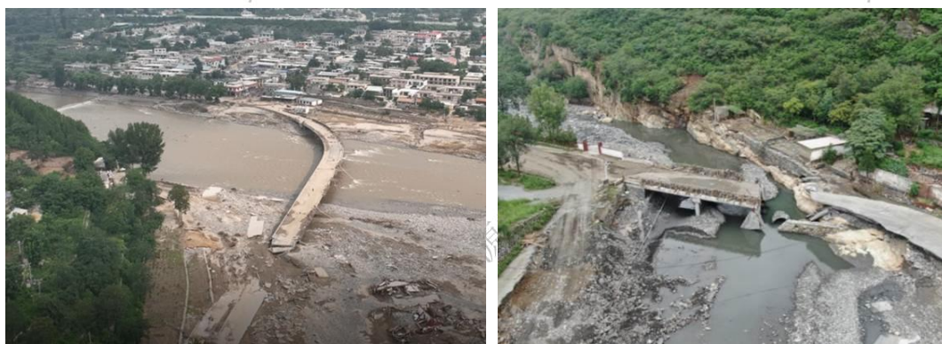
图 4.1.2-4 桥头路基冲毁
