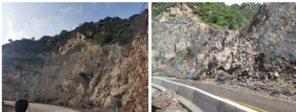
图 4.1.2-3 路堑边坡崩塌
