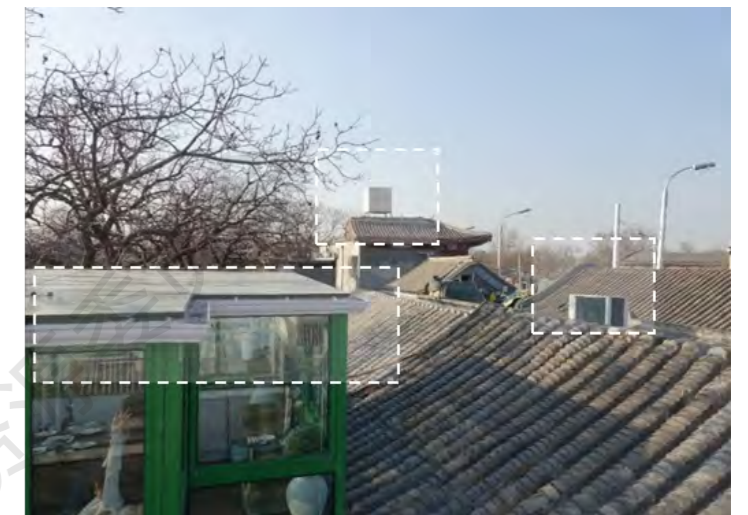
加强建筑屋顶设施管控
