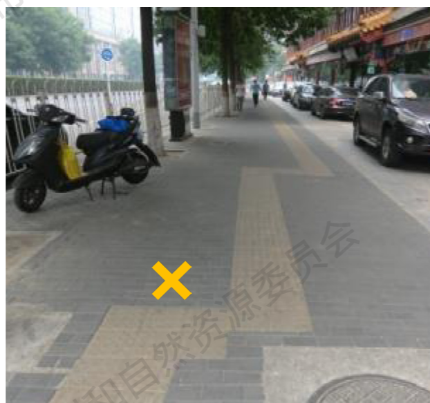
盲道扭折变化，导致视觉障碍者通行不便
