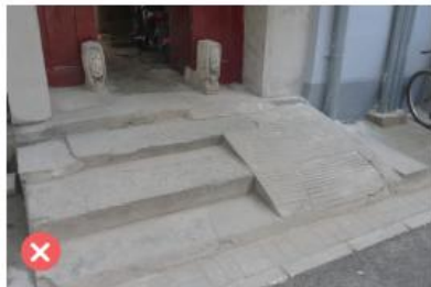
私设水泥坡道，对原有台阶造成永久性覆盖
