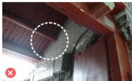
采用硬山搁檩做法，未按传统结构进行街门修缮
