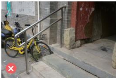
无障碍扶手对原有台阶、墙体造成永久性破坏
