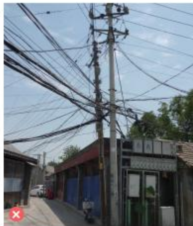
街巷空间内无序架设架空线
